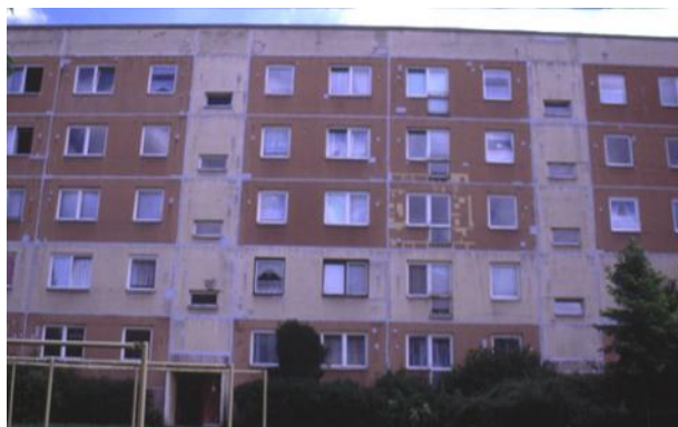
1. fotó Lerobbant homlokzatú épület rehabilitáció el tt
